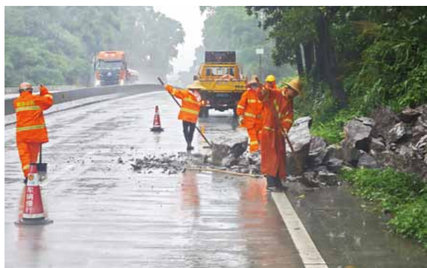
针对河口、岗美等乡镇灾情严峻、道路损毁严重情况，阳春市交通运输局迅速集结8支抢险队伍、32台抢险机械火速奔赴受灾一线支援抢通工作。当前，河口镇上双、下双、梅桐、黄强四条行政村道路已全部恢复通行，顺利打通群众民生出行通道。
