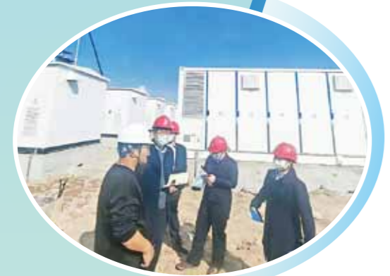
建行阳江市分行深入储能项目工地一线，精准对接需求，定制金融服务方案，全力赋能重点项目建设。
