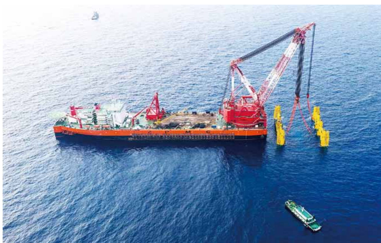
阳江三山岛海上风电柔直输电工程海上换流站导管架钢管桩打桩完成。
